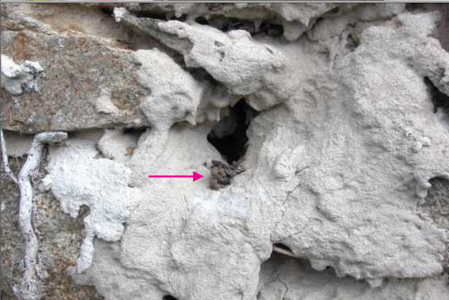
Foto 6: Unverfugte Spalten in der nach West gerichteten Wand der Alten Schule werden wahrscheinlich von Zwergfledermäusen mit genutzt. Fledermauskot am Eingang einer Spalte. 02.05.2020-HGF
